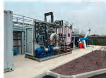
Impianto trattamento rifiuti solidi - Arzignano
